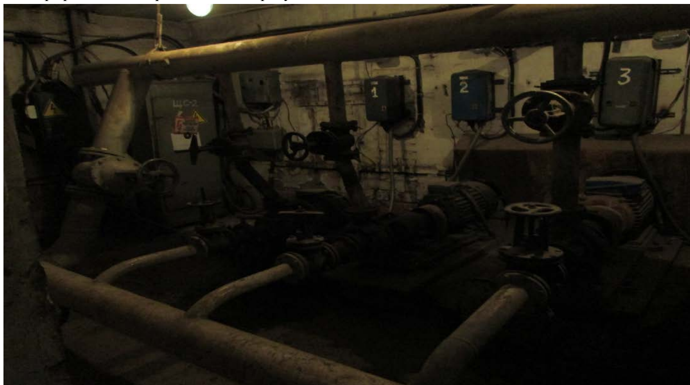
Рис. 1.2.5. Насосы котельной «Центральная».
